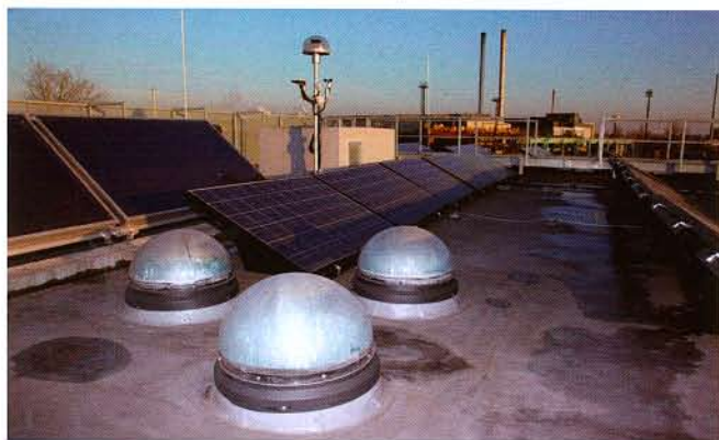
Světlovody, fotovoltaické panely, kolektory pro solární ohřev, meteorostanice
